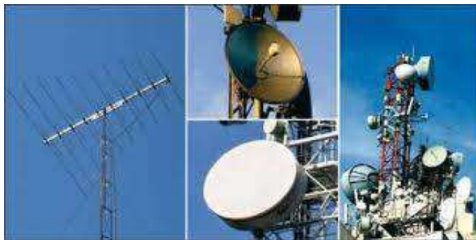
Figura 2.7. Antenas de comunicación
